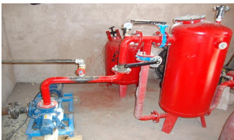
شکل ۵- نمونه‌ای از خط بای پس در محل ایستگاه پمپاژ سامانه آبیاری تحت فشار
