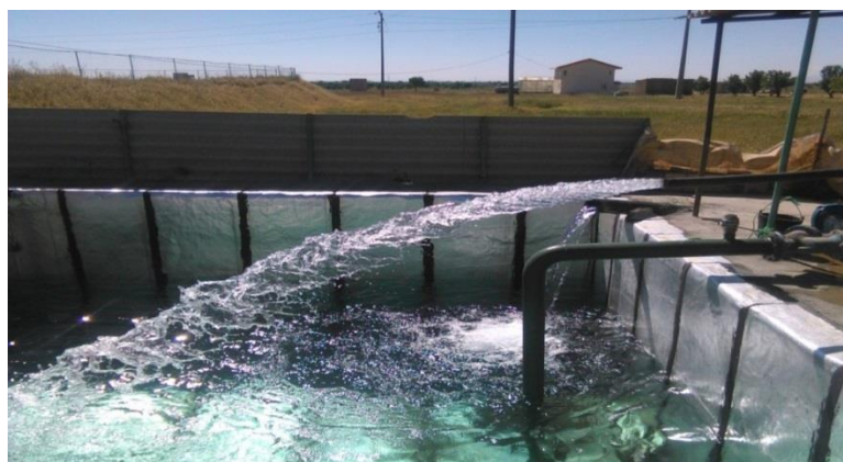
شکل ۴- نمونه‌ای از اتلاف انرژی در ایستگاه پمپاژ به دلیل استفاده از خط بای پس
