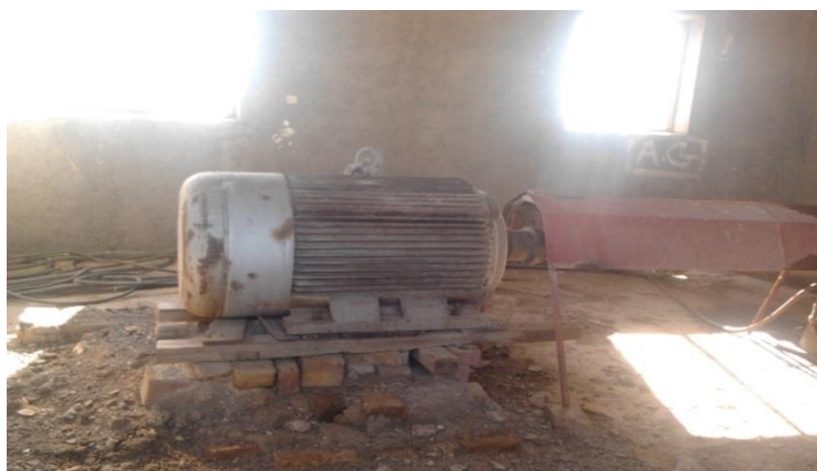
شکل ۱- نمونه‌ای از اجرای نامناسب ایستگاه‌های پمپاژ آب کشاورزی
