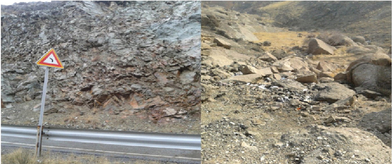
شکل ۱- دو نمونه از دیواره خاکبرداری پوشیده از سنگ و صخره
